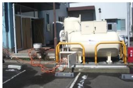
＜災害対応型LPガスタンクの活用例＞
